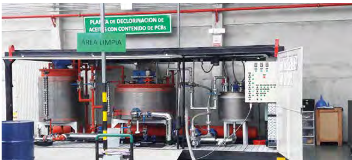
Figura 34. Declorinadora de la empresa TREDI S.A.
