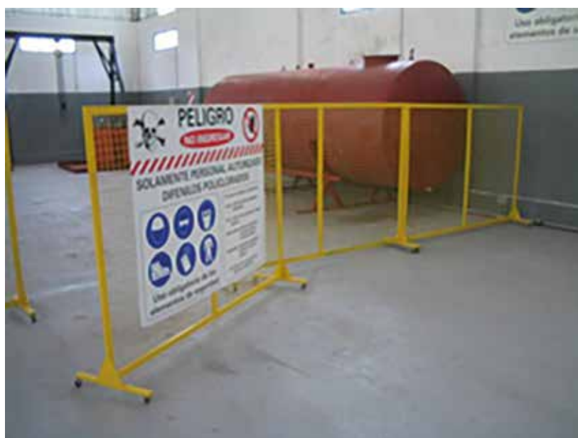
Figura 2. Cerca de protección móvil en área de almacenamiento de PCB
