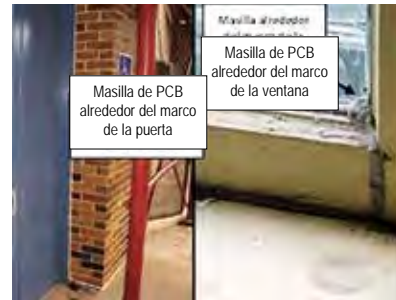
Figura 11. Masilla de PCB en juntas
