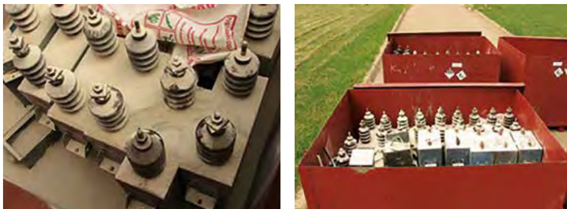
Figura 1. Almacenamiento de capacitores en contenedor. Obsérvese el material absorbente agregado para prevención ante derrames
