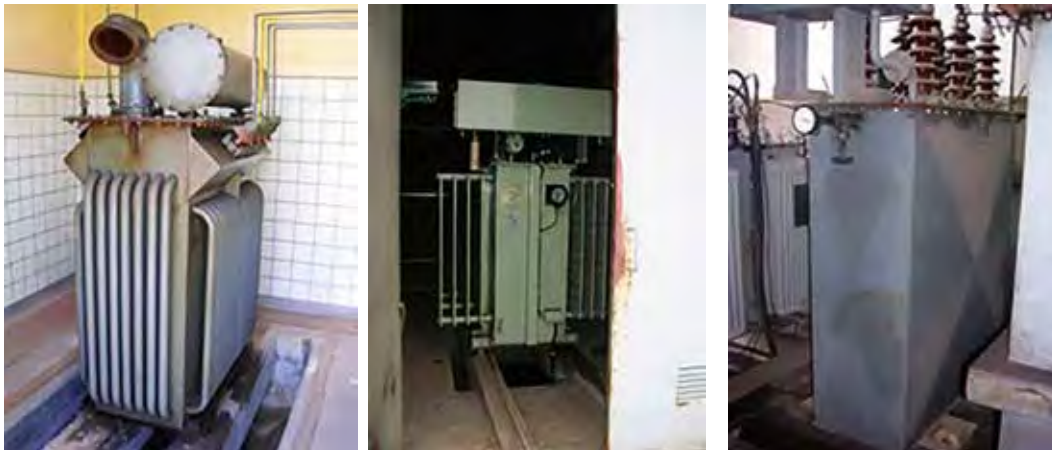
Figura 1. Imágenes de 3 subestaciones; obsérvese que los transformadores del centro y derecha presentan pérdidas y manchas de aceite tanto en equipos como en la instalación
